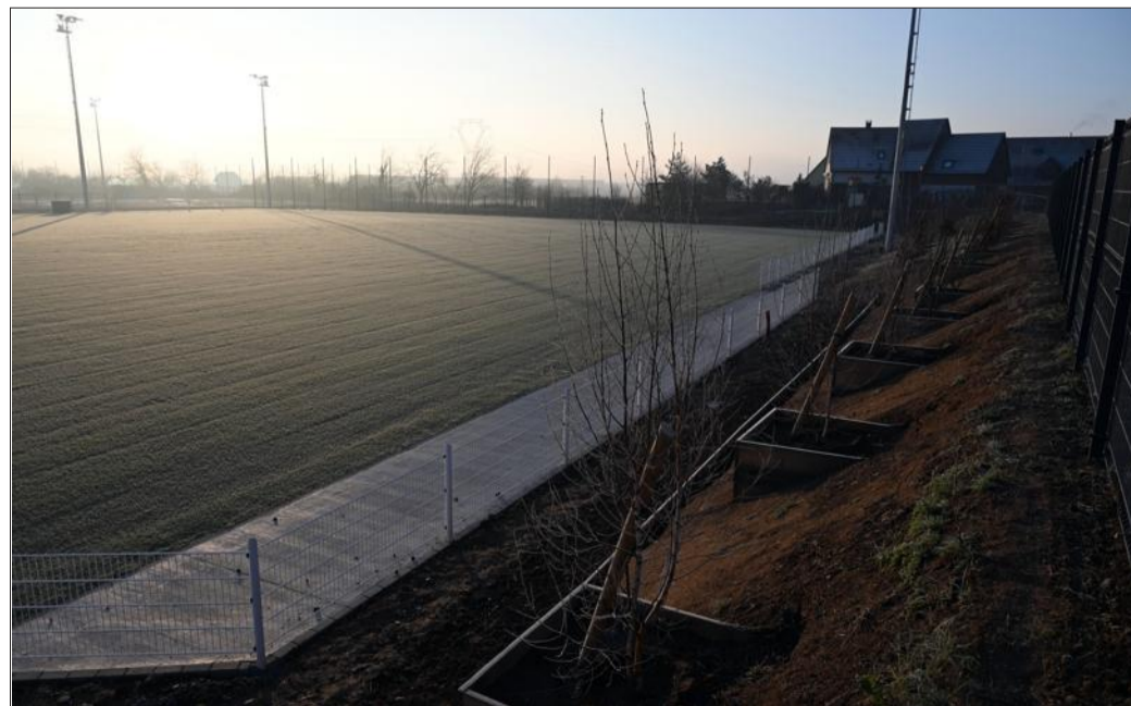
La commune est en train de construire un nouveau complexe sportif doté d'un terrain de foot synthétique, d'un terrain naturel ainsi que d'un nouveau club house. Photo DNA/Franck DELHOMME
